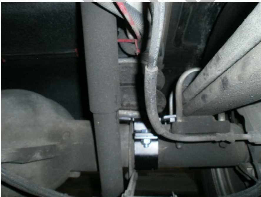
Bild 4: Einbausituation am Fahrzeug
